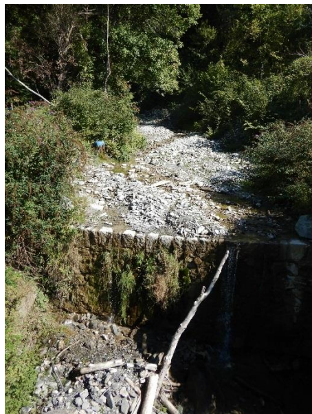
Abbildung 11 Clusa, Abschnitt 1. Bachbett mit künstlich angelegter Schwelle. Die gemauerte Steilböschung an der Seite ist aufgrund des starken Bewuchs nicht auf dem Bild erkennbar.
